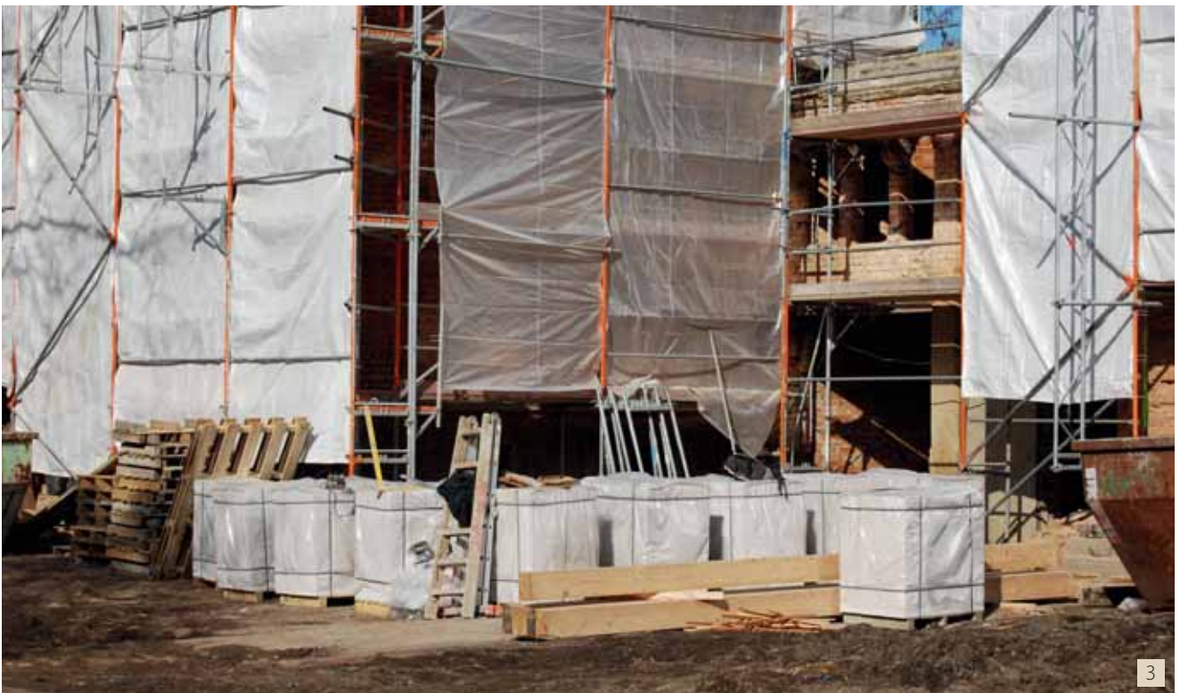
1 sanierungsbedürftiges Mauerwerk mit Gurtgesims
